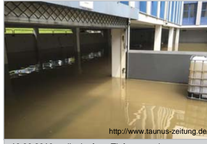
16.06.2016: vollgelaufene Tiefgarage eines Büroparks in Weißkirchen
